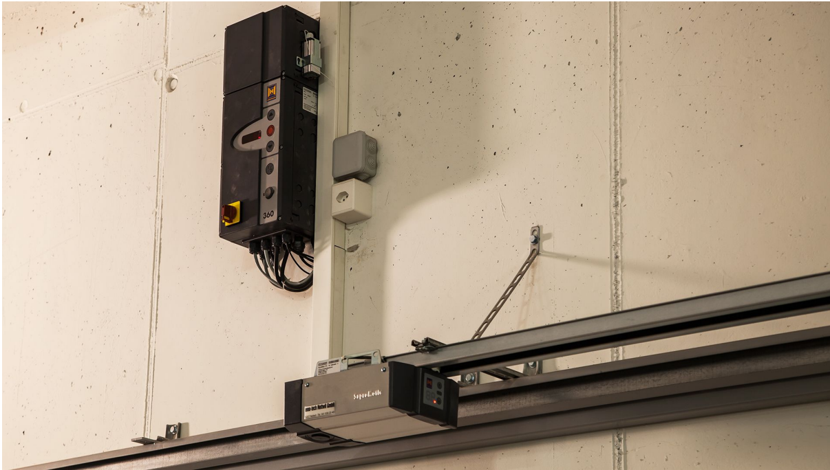
Sammelgaragentor Detail von Antrieb und Steuerung.
